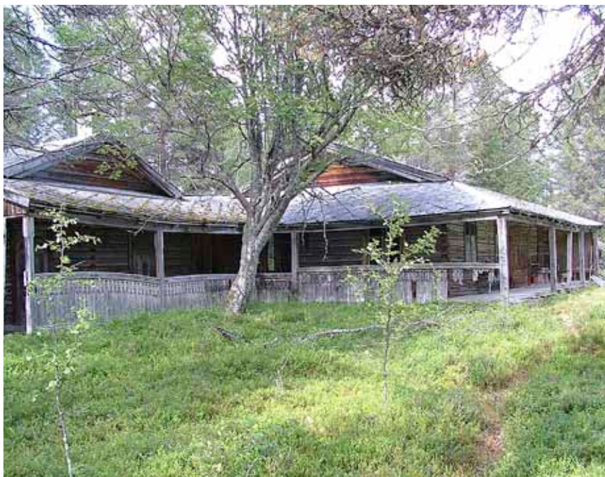
Smithsætra før arbeid med reparasjon av vegger og tak.
