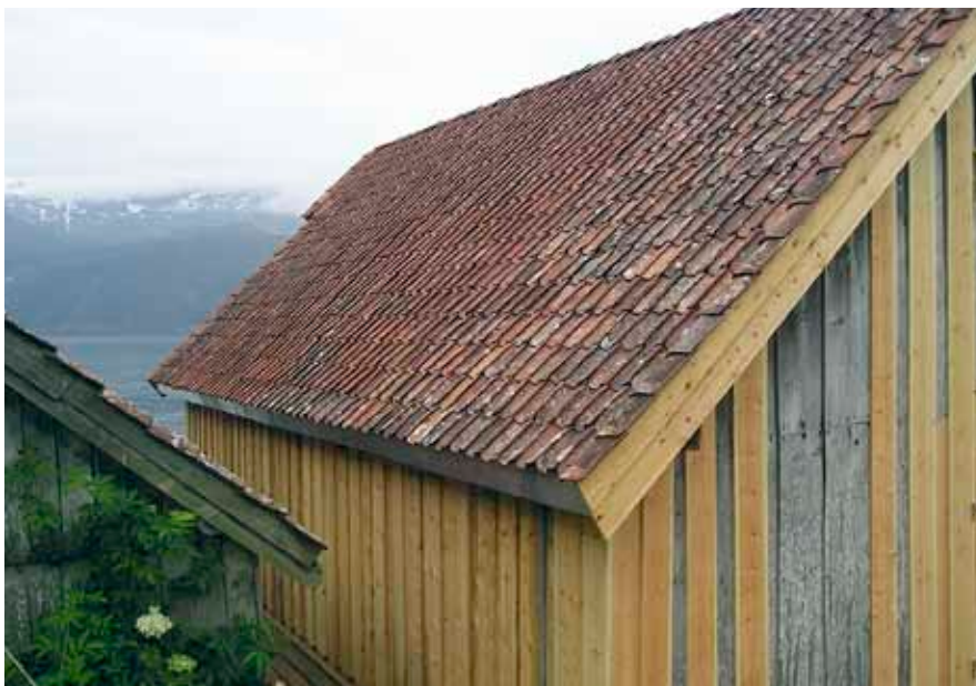
Store deler av kledningen måtte skiftes ut på grunn av de store skadene.
