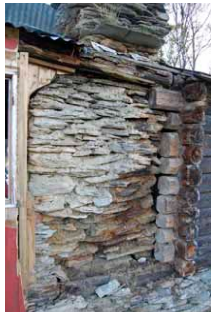
Her vises at fundamentstein er brukket og at bakveggen i grua er forvitret.
